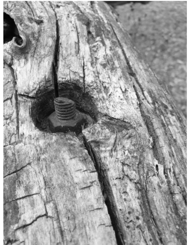
Abbildung 2: überstehende Gewindebolzen Baumstamm-Mikado
